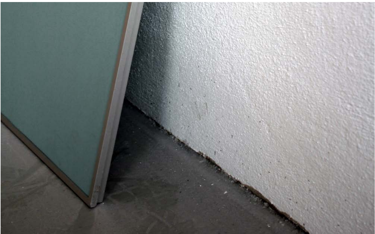
Schnell Handeln: weitere Folgeschäden mit LAWIRO verhindern
